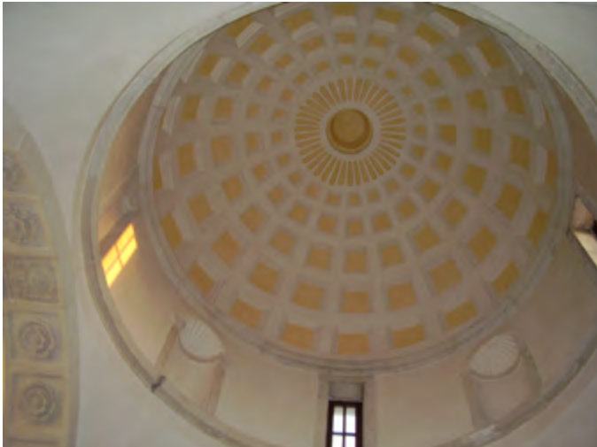
Figura 12. La cupola a lacunari della chiesa di San Michele a Vibo Valentia.
