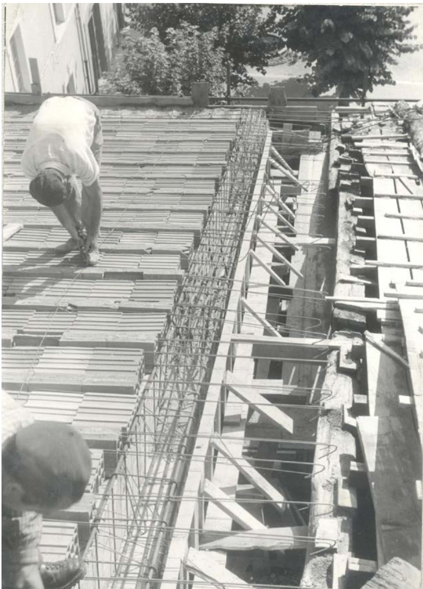
Figura 12. L'Aquila, basilica di San Bernardino. Il rifacimento delle coperture fu compiuto sostituendo la struttura lignea con solai in laterocemento e cordoli in calcestruzzo armato. SABAP-AQ, archivio fotografico, neg. 7741, anno 1960. Uso immagine su autorizzazione del MiC – Soprintendenza ABAP per le province di L'Aquila e Teramo (SABAP-AQ).
