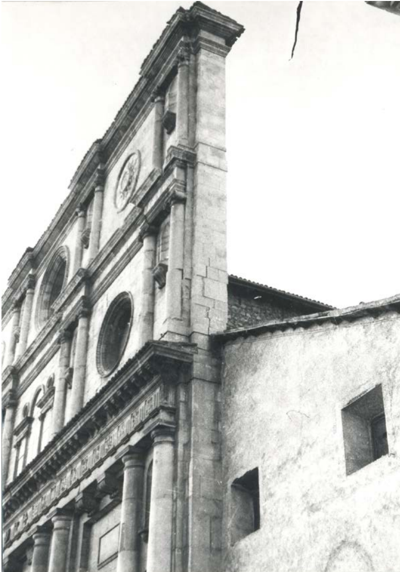
Figura 3. L'Aquila, basilica di San Bernardino, particolare del dissesto che motivò la completa scomposizione. Si osserva sullo spigolo destro la dislocazione dei conci e della porzione inferiore della colonna. SABAP-AQ, archivio fotografico, neg. 7046, anno 1959. Immagine su autorizzazione del MiC – Soprintendenza ABAP per le province di L'Aquila e Teramo (SABAP-AQ).
