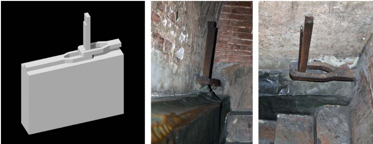
Figura 9a-c. Giunti di tipologia C: modello 3D e vano 8 (foto ed elaborazione S. Celli, F. Ottoni, 2018).
