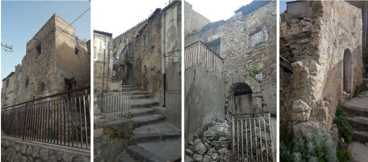
Figura 8. Edifici e spazi urbani in abbandono all'interno del quartiere Granfonte (foto di R. Ledda, 2018).
