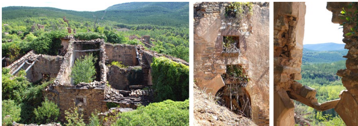
Figura 2. Stato attuale di Ruesta. Fattori biotici, abiotici e antropici responsabili del degrado (foto ©Sergio Sebastián Architects, 2017).
